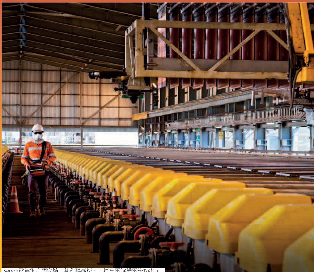
Sepon 電解銅車間安裝了替代陽極板，以提高電解槽電流功率。
